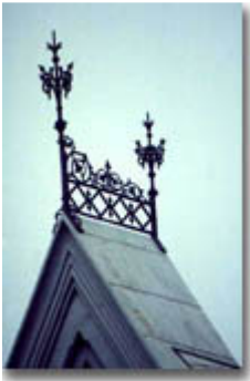
Toiture du presbytère de la paroisse Sainte-Cunégonde de Montréal, Photo : François Brault
